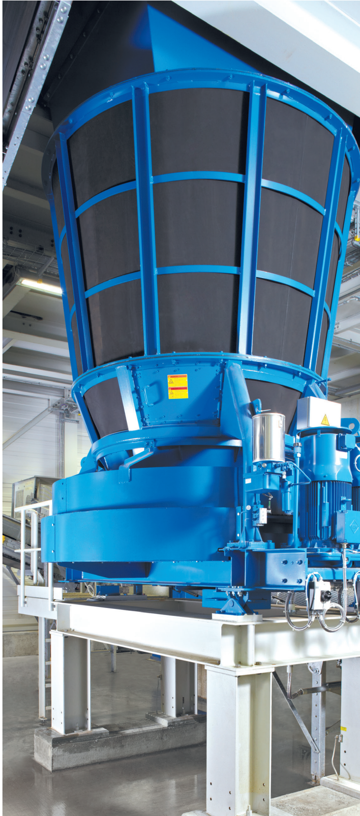
Telleraufgeber UE25 in einer Gießerei mit Materialaufgabetrichter für 9000 L Volumen
