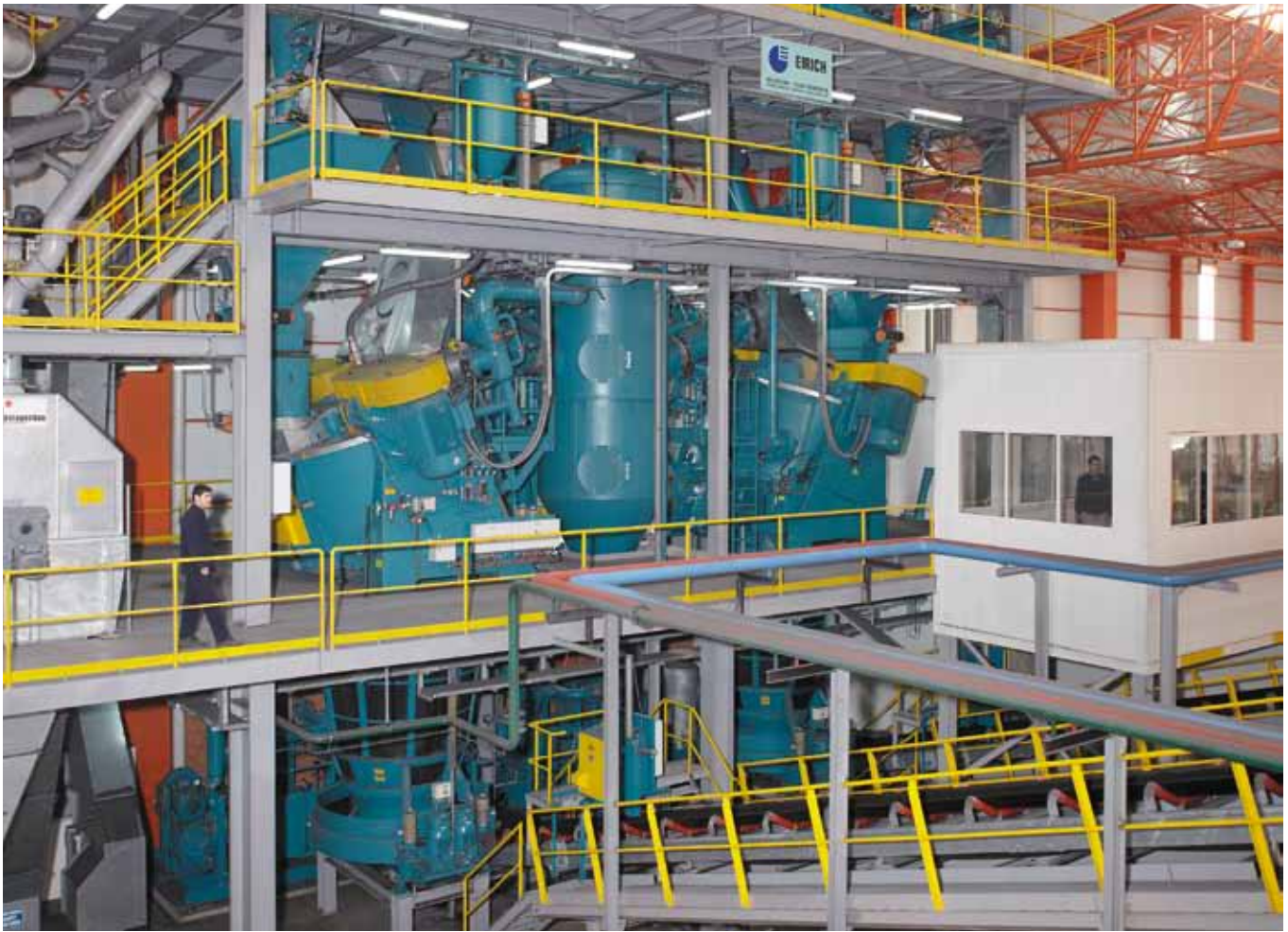
Abb. 6.1: Zwei EIRICH-EVACTHERM®-Mischkühler RV32 VAC (7 m 3 /Charge) für ca. 260 t/h Fertigsandbedarf.
